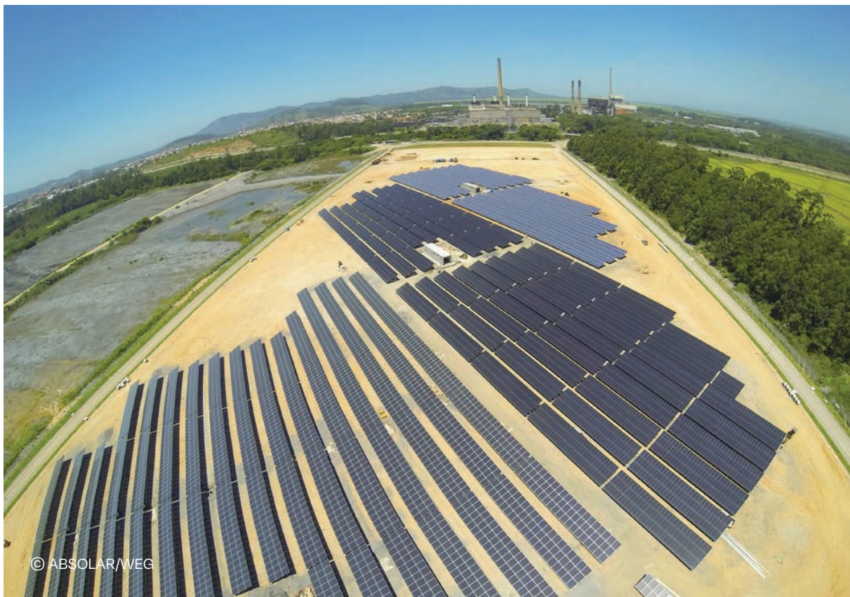
3 MW Cidade Azul Solar Plant, Tubarão, Brazil
